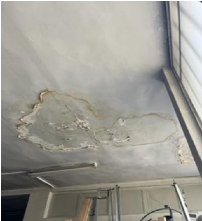
نمزدگی دیوار و سقف
